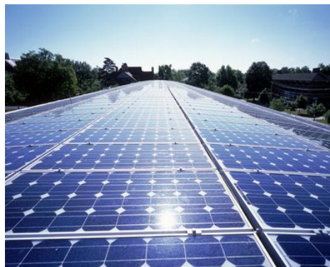
Σχήμα 3.1: Φωτοβολταϊκή εγκατάσταση παραγωγής ηλεκτρικής ενέργειας
